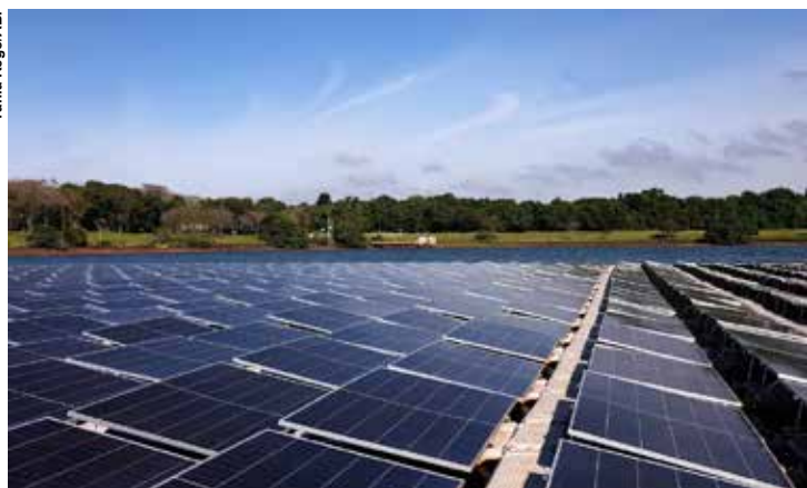
Ao todo, foram instalados 1.584 painéis fotovoltaicos em uma área de menos de 10 mil metros quadrados (m 2 ) sobre o lago.
